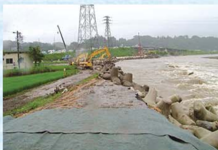
洪水被害の状況(平成18年, 長野県箕輪町)
