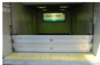
地下駅出入口 止水板
