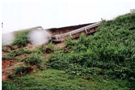
写真 2.1.6 堤防の不安定化、損傷
