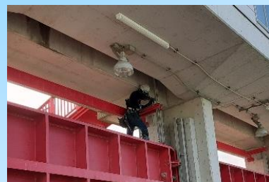
機械設備点検
